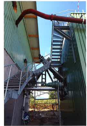
Liaison et accès entre halle et fermenteur
