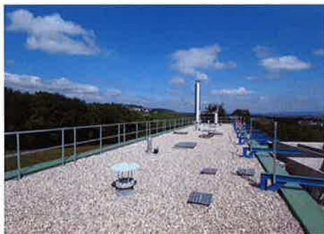
Le toit du fermenteur avec la torchère de sécurité
